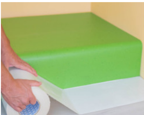
1. Colocación de Mapecontact Plus en la huella y después en la contrahuella
